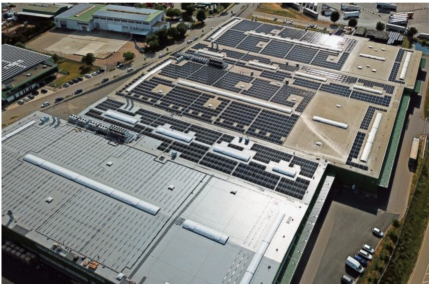
Viele Unternehmen verfügen auf ihren Betriebsgebäuden über erhebliche Flächen, die sich zur Installation auch großer Photovoltaik-anlagen nutzen lassen. Foto: pr
